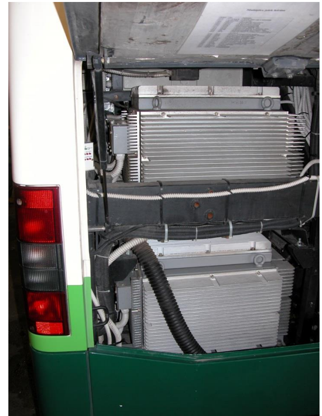
Statikus átalakító CEGELEC SMTK 7,0 Z
